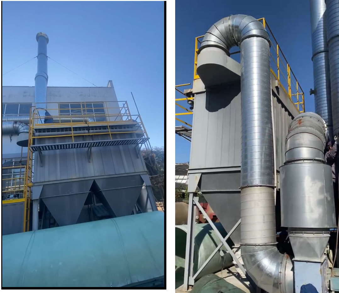
布袋除尘设施及其排放口
