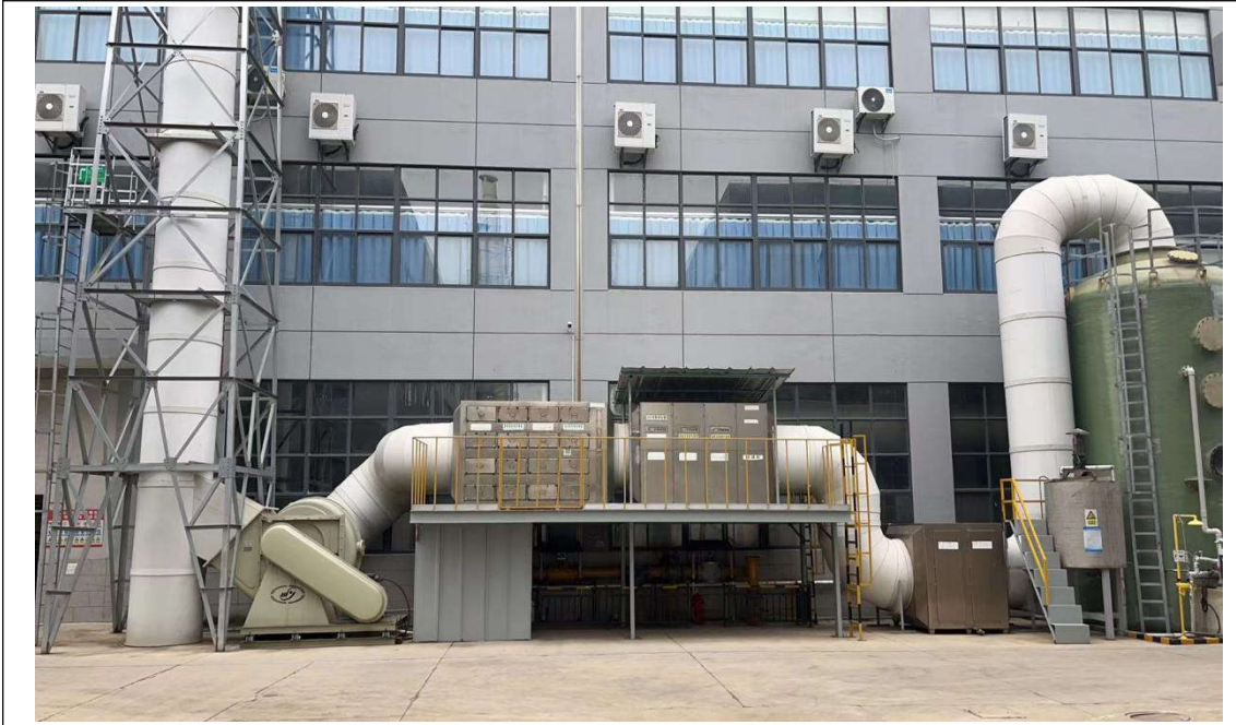
厂房 5 后烘干废气处理设施及排放口(DA007)
