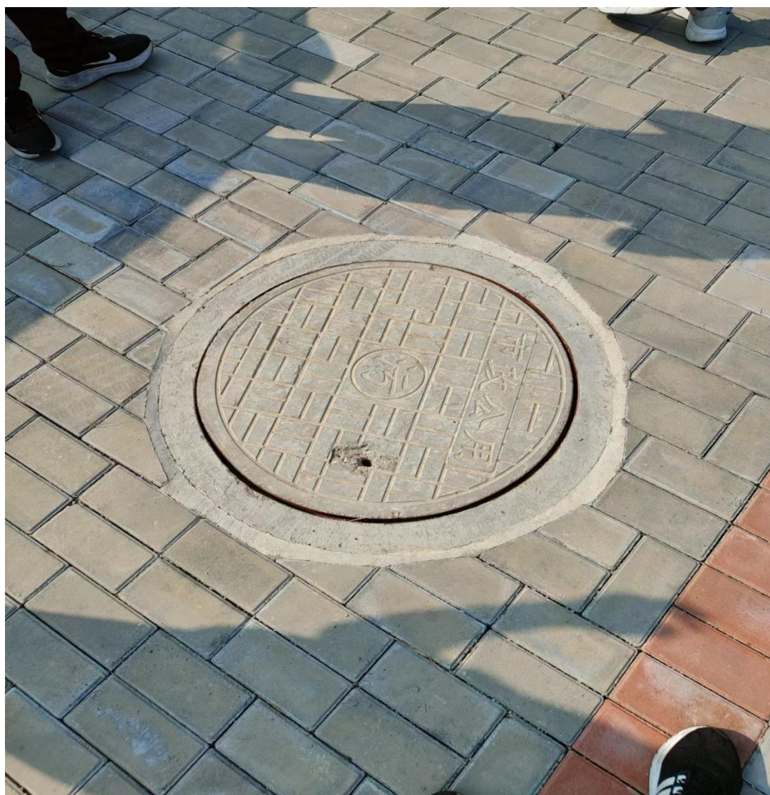
图 3-1 项目污水接管口
