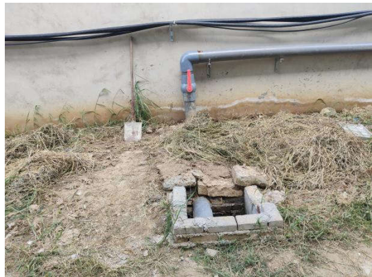
项目污水接管口
