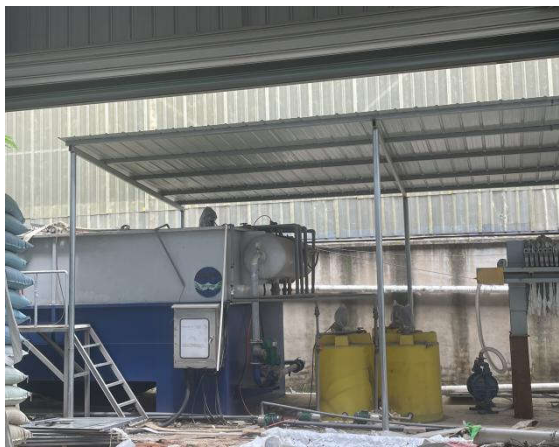
项目污水处理设施
