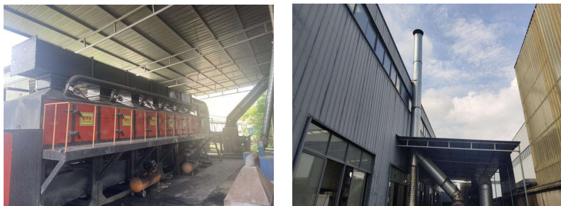
吸附/脱附+催化燃烧设施
