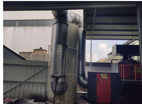
喷淋塔+干式过滤箱
