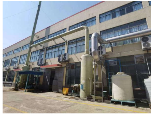
线下酸洗、消毒废气处理设施(DA008)
