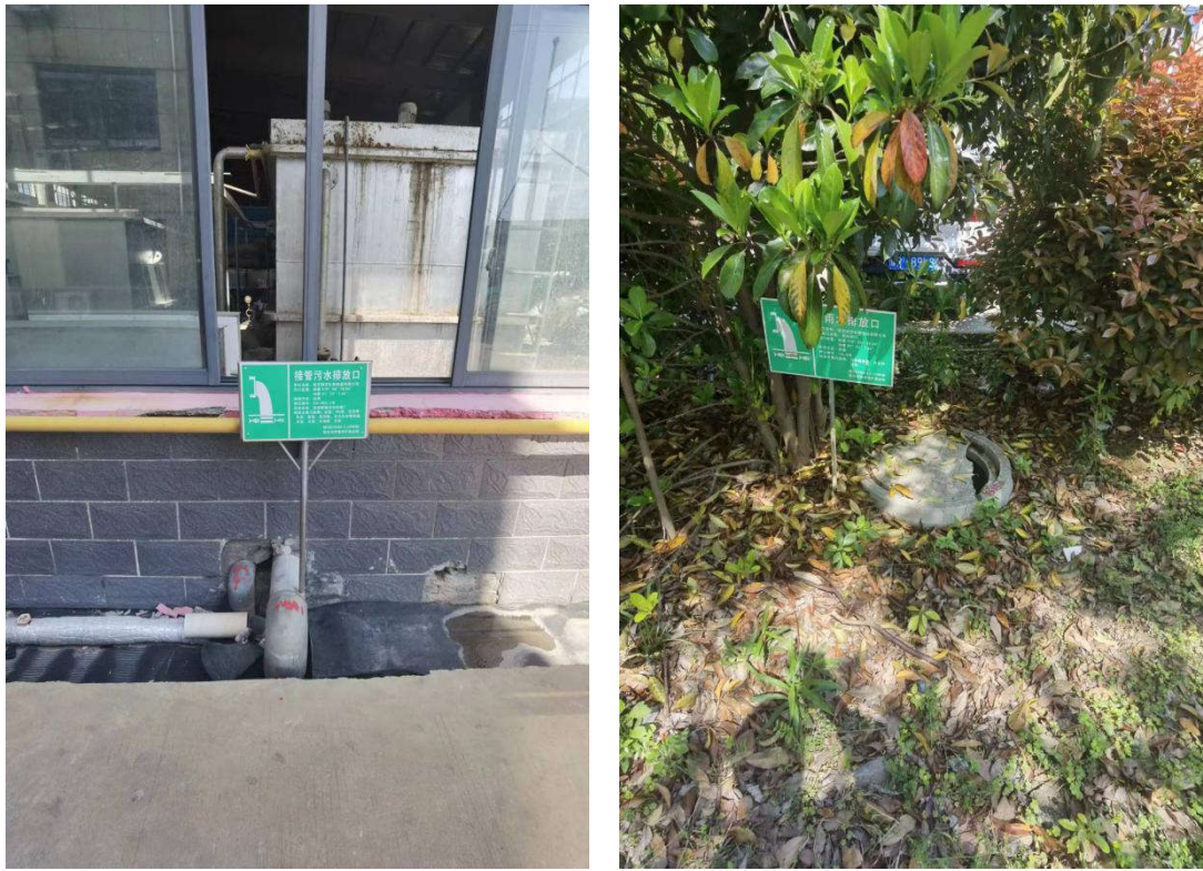
项目污水接管口
