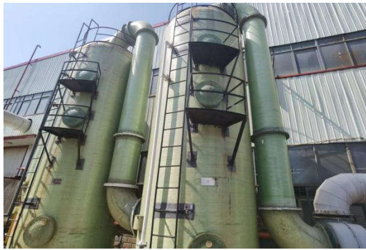
线上消毒废气处理设施(DA006)
