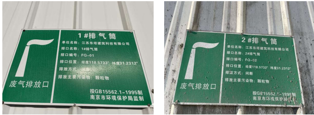
图 3-4 项目废气收集及治理设施
