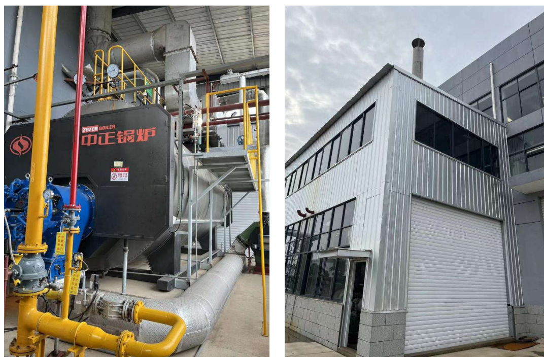
图 3-1 锅炉及废气排放口
