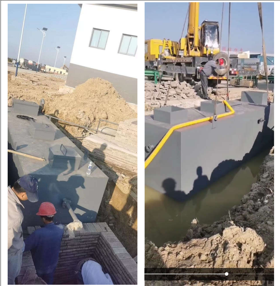
项目地埋式污水处理设施
