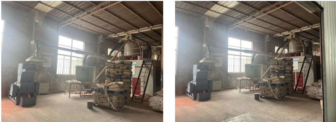
图 3-4 投料、混料、破碎、切割粉尘收集措施
