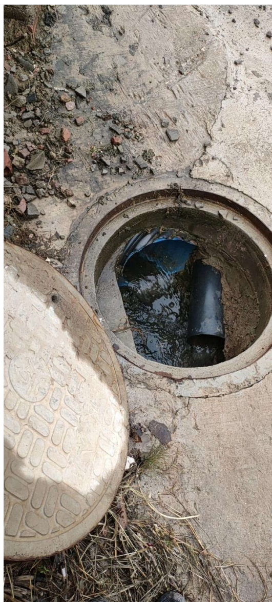
项目污水接管口
