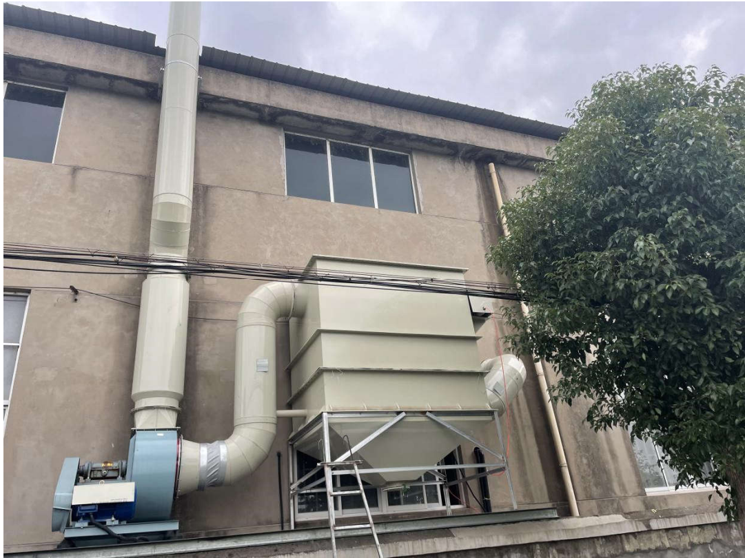
图 3-5 投料、混料、破碎、切割粉尘处理设施
