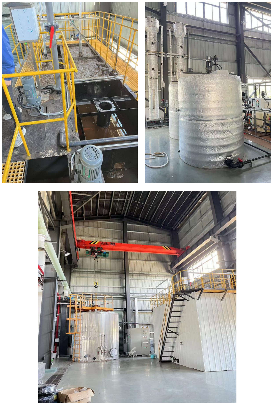
图 3-1 废气收集及处理设施
