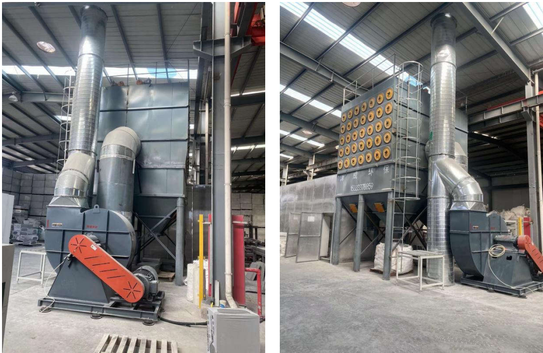
投料、切片废气处理设施
